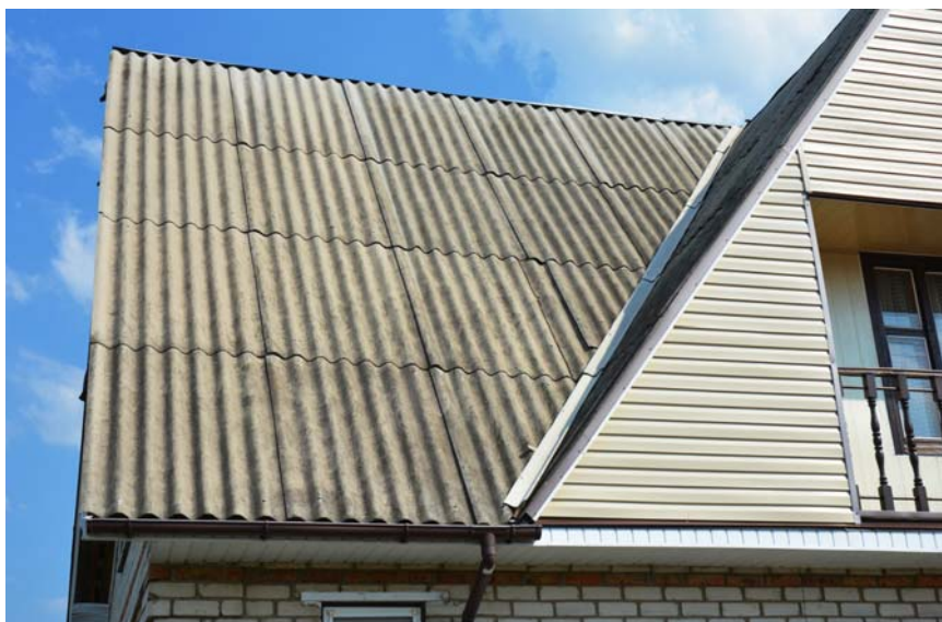
Fot. 5. Pokrycie dachu materiałem z azbestu.
