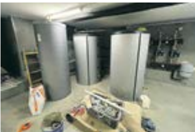
A tak wygląda nowa kotłownia w szkole w Osowej Sieni.
