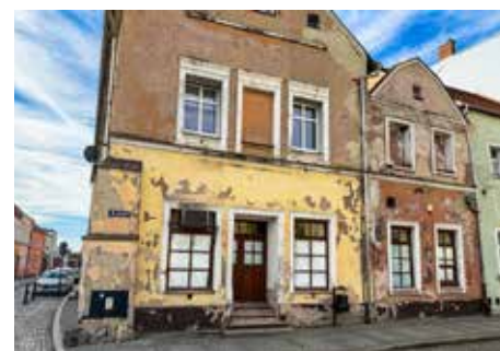
Dziś nie wygląda dobrze, ale ta kamienica zmieni się pod potrzeby placówki wsparcia dziennego
